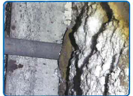
Décision opérateur n° 2 : Conduits 1 Fibres ciment (dans Immeuble principal Enveloppe Combles)
