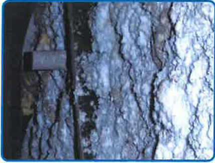
Décision opérateur n° 3 : Conduits 2 Fibres ciment (dans Immeuble principal Enveloppe Combles)
