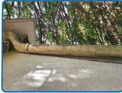
Décision opérateur n° 4 : Descentes 1 EP droite Fibres ciment (dans Immeuble principal Enveloppe Clos)
