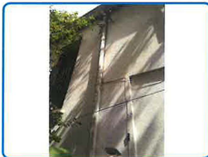
Sondage sur ZPSO n° 4 : Descentes 3 EP Fibres ciment (dans Immeuble principal Enveloppe Clos)
