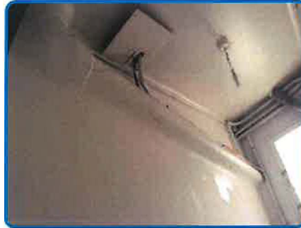
Décision opérateur n° 7 : Conduits horizontal Fibres ciment Peinture (dans Immeuble principal RDC Appt duplex Buanderie)
