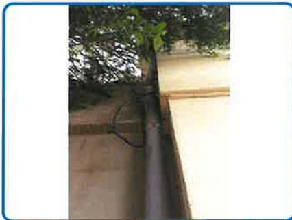
Décision opérateur n° 4 : Descentes 1 EP droite Fibres ciment (dans Immeuble principal Enveloppe Clos)
